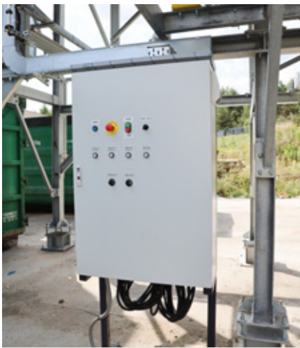
Do obsługi stacji służy niewielka szafa sterownicza. Kluczową rolę odgrywają w niej cztery przyciski odpowiadające za wybór kontenera, do którego mają być skierowane odpady.
