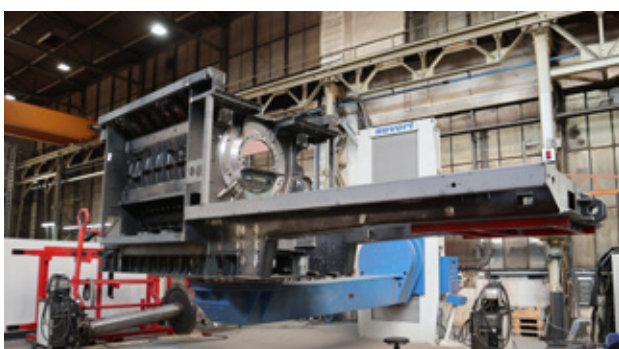
Ciekawym przykładem integracji nowych urządzeń i technologii z halami pochodzącymi z końca lat 60. ub. wieku jest pozycjoner spawalniczy ułatwiający pracownikom dostęp do każdego zakamarka przy montażu korpusu rozdrabniacza.
