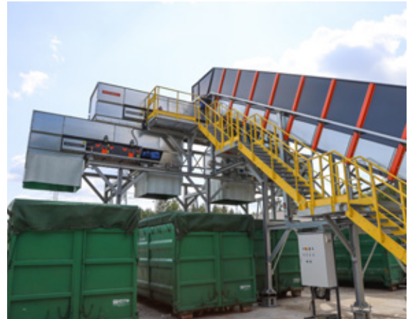
Wzdłuż przenośnika wznoszącego znajdują się szerokie schody z poręczami, zapewniające wygodny i bezpieczny dostęp do najwyższych elementów stacji.
